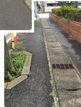
歩道の中心に側溝がある通学路 街路樹の根上りのため凹凸も
